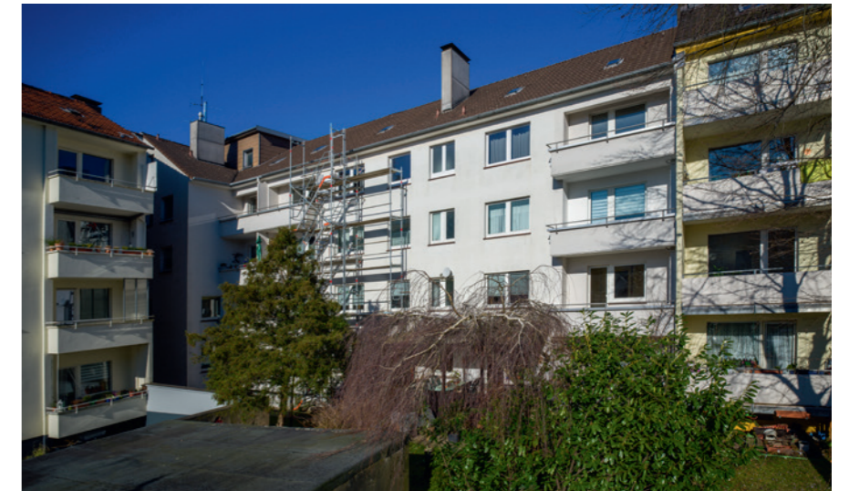
↑ Ein zweiter Rettungsweg für den vorbeugenden Brandschutz war Anlass, zusätzliche Balkone für Wohnungen in der Gerstenstraße zu planen und ein energetisches Maßnahmenpaket anzuschließen; Foto: © ebv
