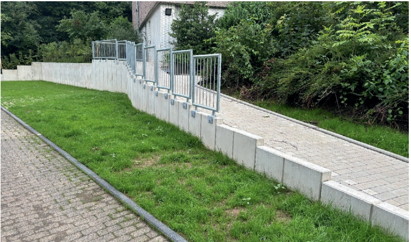
Im Rahmen der neuen Feuerwehraufstellfläche konnte gleichzeitig für die Köttershöhe 10 ein barrierearmer Zugang geschaffen werden; Foto: © Anette Gericke
