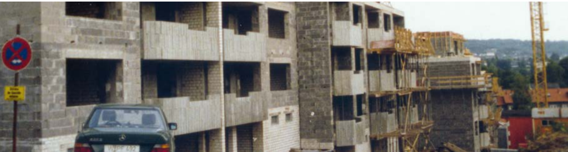
Siedlung Eskesberg. Bereits 1983 hatte der Eisenbahn-Bauverein am Wichernweg mit der Bebauung des Eskesberg in Elberfeld begonnen. Nach dem Bauboom der 1970er Jahre kam es hier aufgrund nun fehlender Wohnungsnachfrage zum Baustopp.
