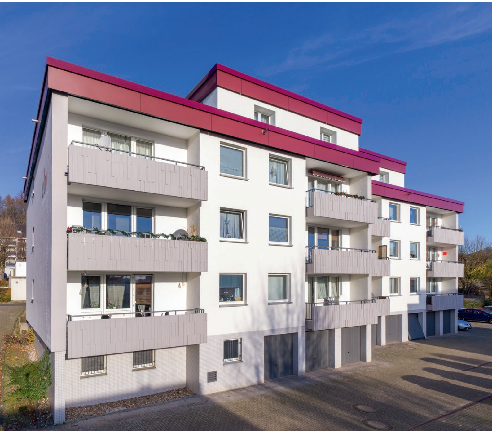
In der Krummacherstraße gewannen die Gebäude durch die Sanierung von Balkonen und Dächern an Attraktivität. Foto: © ebv.
